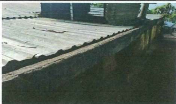
Foto 3: La estructura de bajada de agua pluvial ocasiona filtración agua de lluvia en una de las aulas por falta de mantenimiento.
