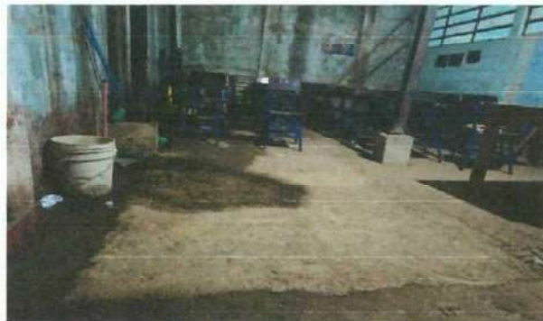
Foto 2: Situación actual del piso de torta de concreto en una de las aulas con necesidad de remozamiento.
