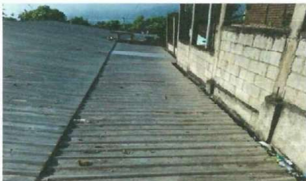
Foto 1: Estado actual de la cubierta de lámina en un extremo del modulo con las láminas deterioradas y con agujeros.
