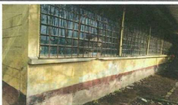
Foto 4: Las paredes exteriores e interiores del centro educativo ameritan mantenimiento con aplicación de pintura.
